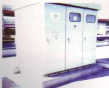
変電所キュービクル
